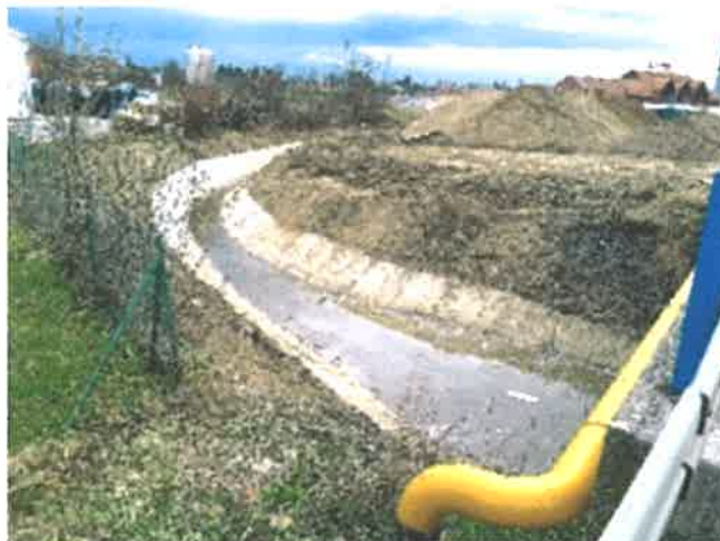
Slika 8. Bujičar Janiševec nizvodno od mosta na sjevernoj veznoj cesti
