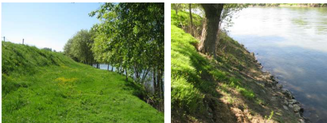
Slika 1.1-3. i 1.1-4. Uski inundacijski pojas, erozija obale i loše stanje obaloutvrde
