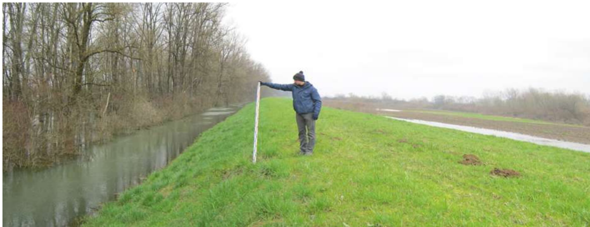
Slika 1.1.1-13. Pogled na dio nasipa na lokaciji pukotine s vodne i zaobalne strane
