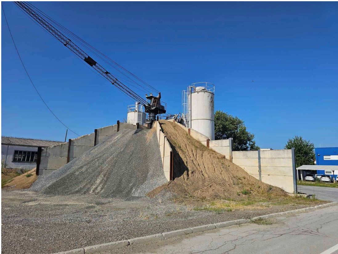
Slika 24. Betonara – zvjezdasto skladište kamenih agregata i toranj s korpom za doziranje kamenih agregata (Izvor: PZC BROD d.o.o., kolovoz 2025.)
