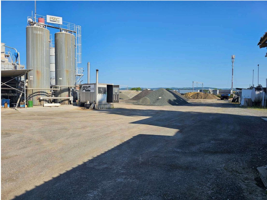
Slika 21. Asfaltna baza – spremnici bitumena (Izvor: PZC BROD d.o.o., kolovoz 2025.)
