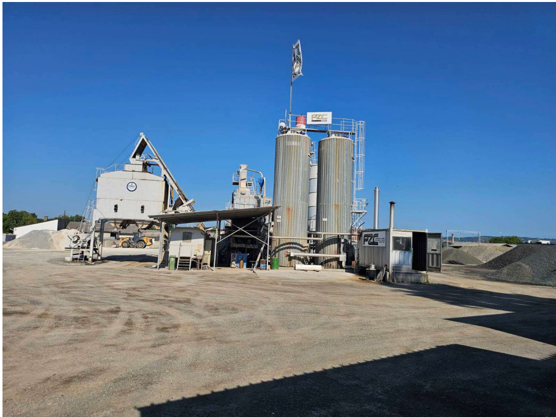
Slika 22. Asfaltna baza – upravljačka prostorija i spremnici bitumena (Izvor: PZC BROD d.o.o., kolovoz 2025.)
