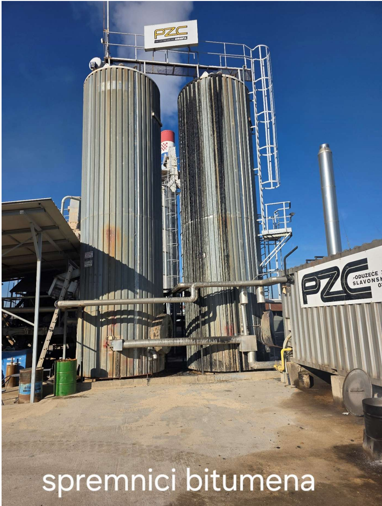
Slika 11. Asfaltna baza – spremnici bitumena (Izvor: PZC BROD d.o.o., kolovoz 2025.)
