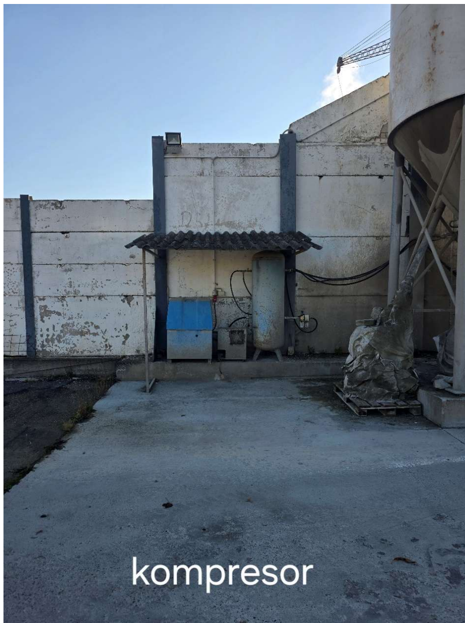
Slika 27. Betonara – kompresor (Izvor: PZC BROD d.o.o., kolovoz 2025.)
