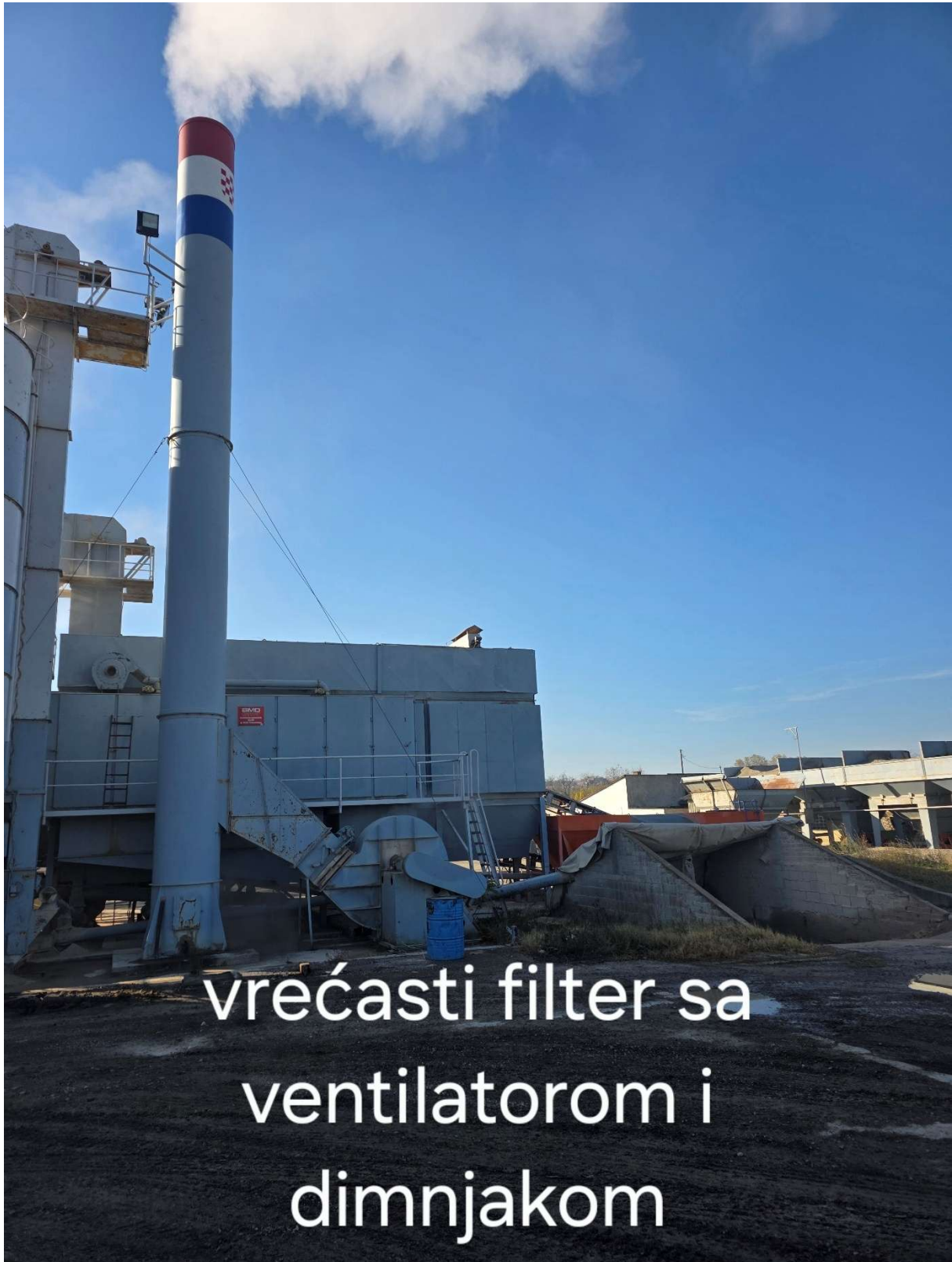
Slika 14. Asfaltna baza – vrećasti filter s ventilatorom i dimnjakom (Izvor: PZC BROD d.o.o., kolovoz 2025.)
