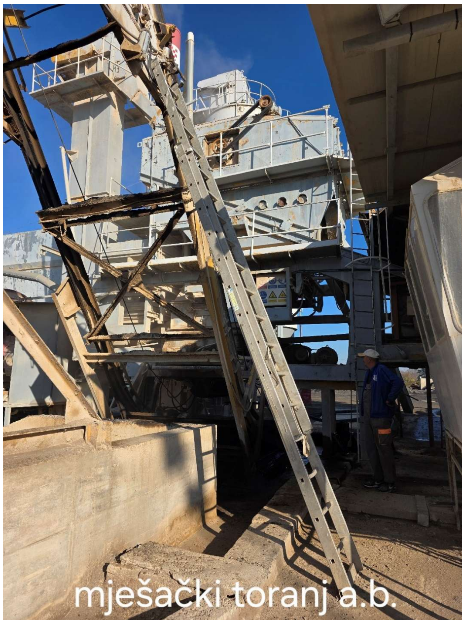
Slika 18. Asfaltna baza – mješački toranj (Izvor: PZC BROD d.o.o., kolovoz 2025.)
